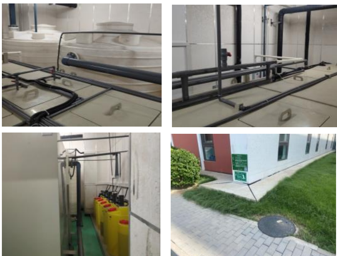
图 3.3-11 污水处理站及总排口现场照片
