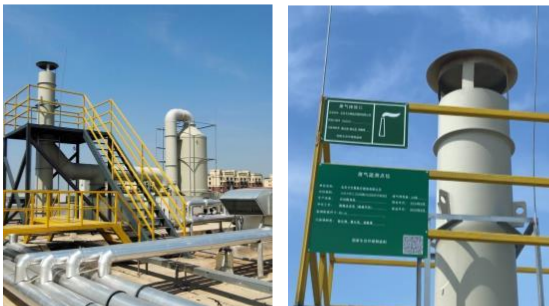
图 3.3-9 酸碱喷淋塔及排放口现场照片
